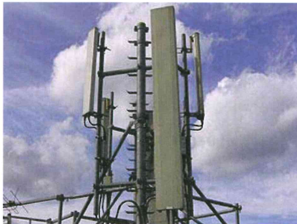
Una stazione radio base (BTS) GSM posizionata su un tetto
