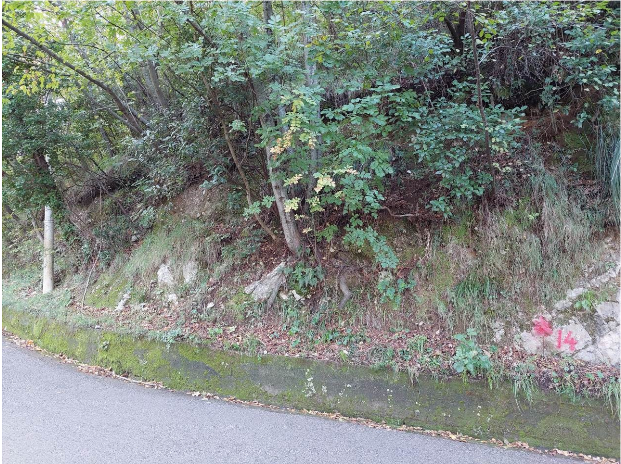
Foto 1 – area da sottoporre ad intervento mediante rafforzamento corticale, rete e geo stuoia
