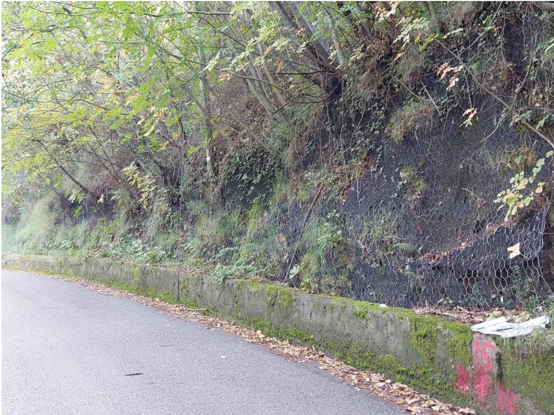
Foto –intervento di messa in sicurezza con rete e geo stuoia precedentemente realizzato
