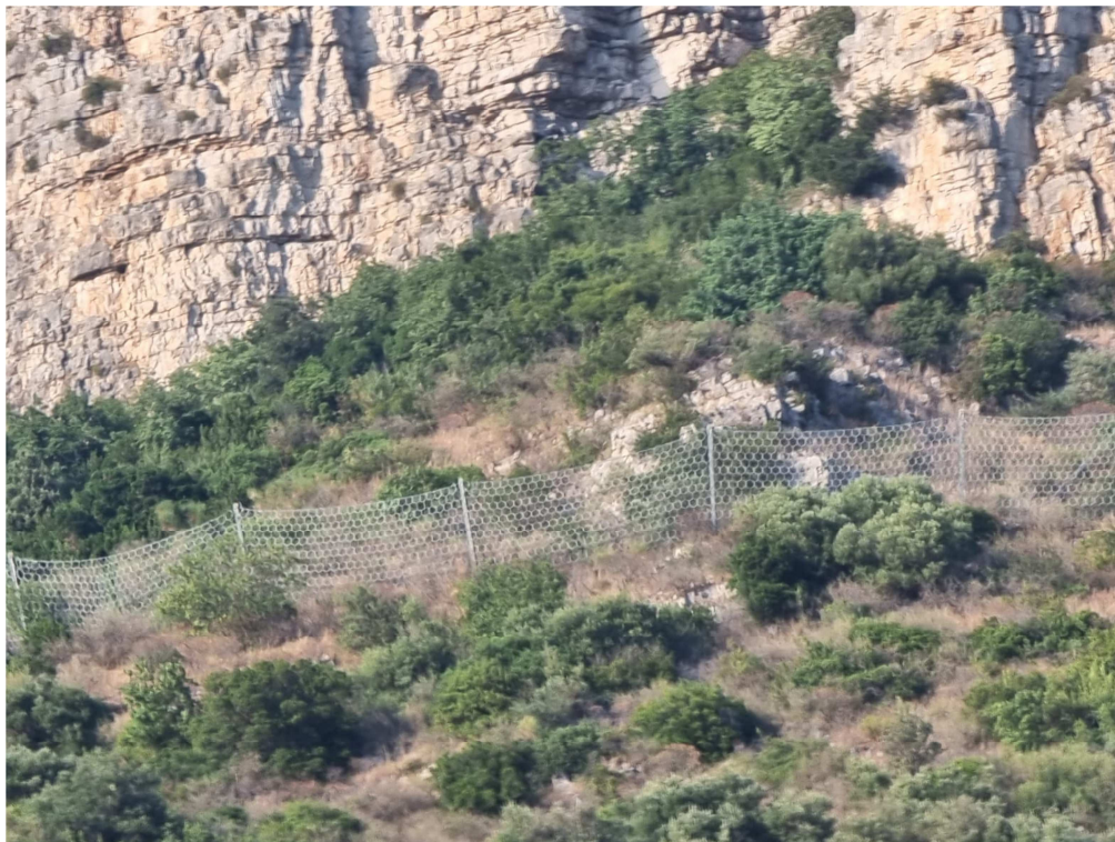
Foto 5 Tipologia simile di barriera paramassi in località Alberi, Meta.
