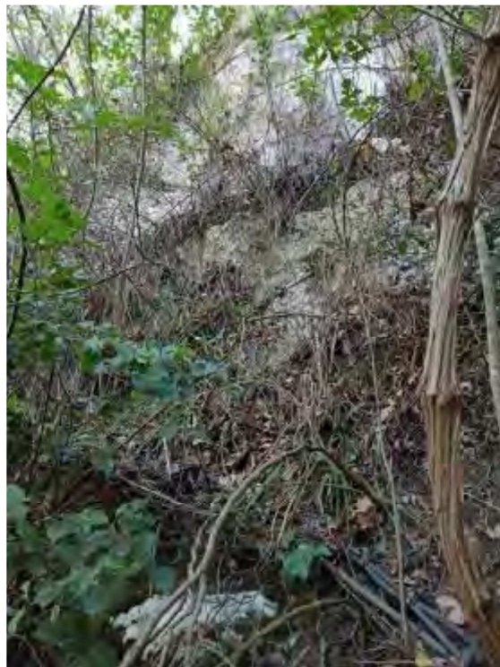
Foto 9 Rete paramassi (lotto precedente) ricoperta da vegetazione spontanea.
